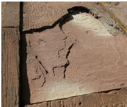
Losgelöste Schale an der Außenhaut.
