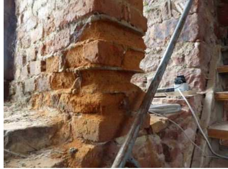
Stark verwitterte Ziegelsteine am Pfeiler im Turminnenraum nach Wassereintritt.
