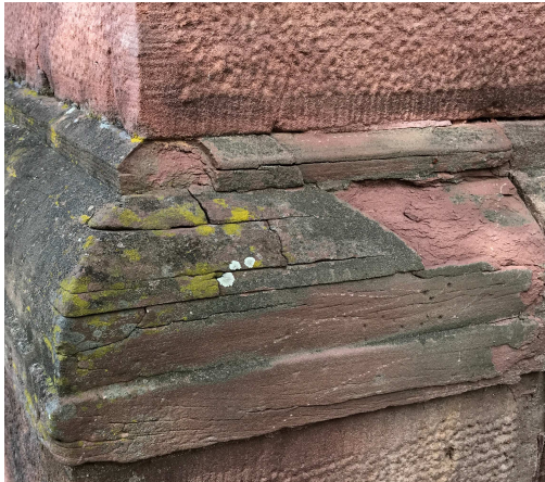
Abgeplatzte Passagen am Sockel.
