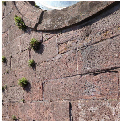
Verschobene Mauersteine; kleine Büsche sprengen die Fugen; Salzausblühungen im Mauerwerk.
